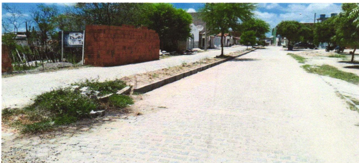
Foto 03 – ASSENTAMENTO DE GUIA (MEIO-FIO) EM TRECHO RETO, CONFECCIONADA EM CONCRETO PRÉ-FABRICADO, DIMENSÕES 100X15X13X20 CM (COMPRIMENTO X BASE INFERIOR X BASE SUPERIOR X ALTURA), PARA URBANIZAÇÃO INTERNA DE EMPREENDIMENTOS. AF_06/2016_P
