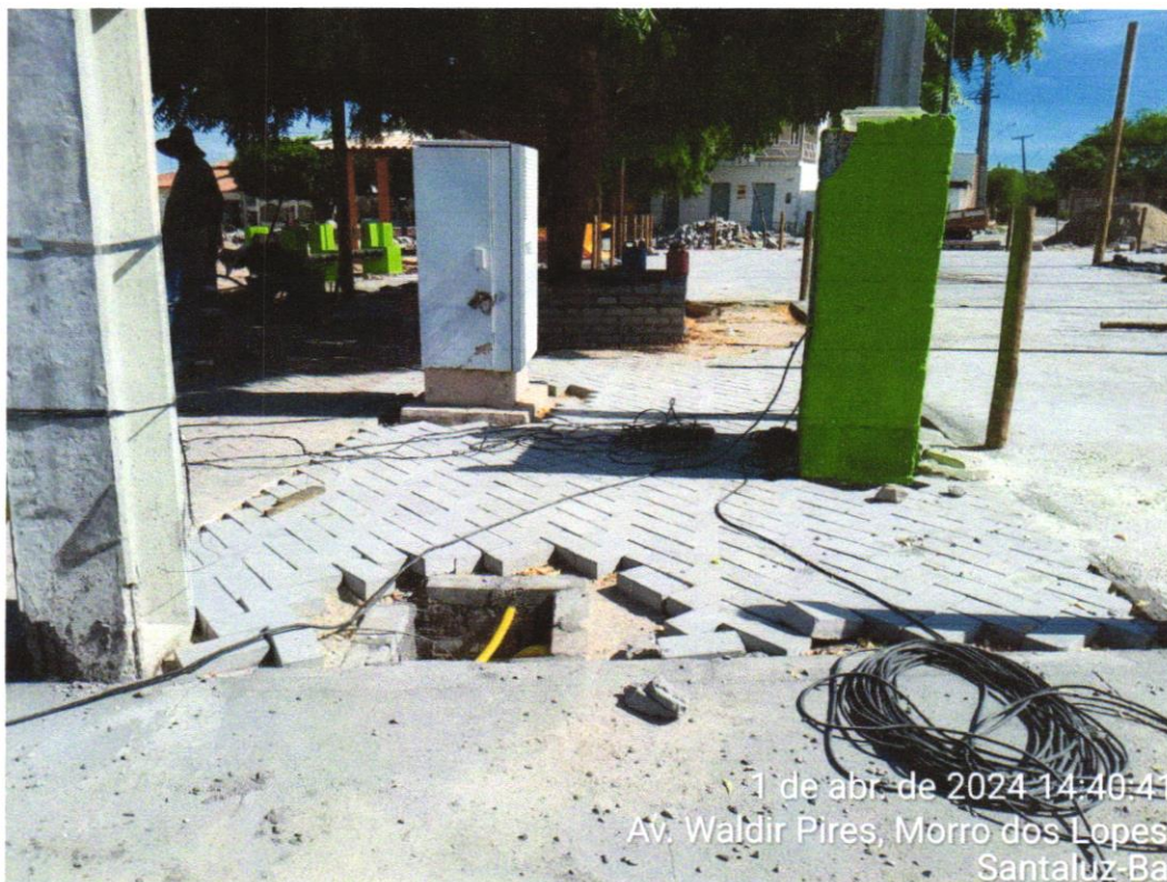
Foto 13 - ELETRODUTO FLEXÍVEL CORRUGADO REFORÇADO, PVC, DN 20 MM (1/2"), PARA CIRCUITOS TERMINAIS, INSTALADO EM FORRO - FORNECIMENTO E INSTALAÇÃO.
